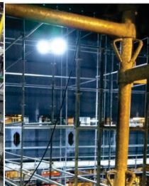
Sistema de iluminação para Espaço Confinado - Caldeira de Recuperação
