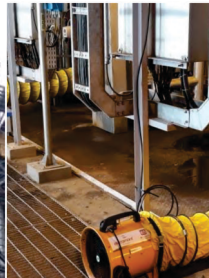
Equipamentos de Exaustão para conforto térmico
