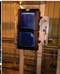
Instalação e comissionamento Analisador de Fosfato
